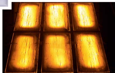
有破裂组件的CIS组串
